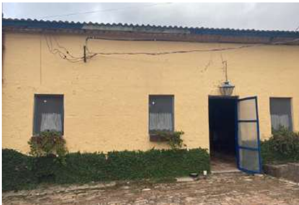
Figura 3. Vista externa da casa de máquinas da Fazenda Nossa Senhora da Conceição.
